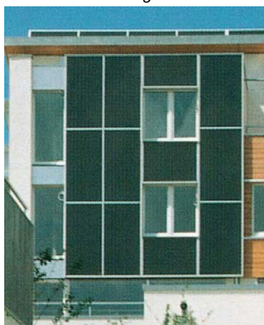
Abb. unten: Photovoltaik-Anlage
